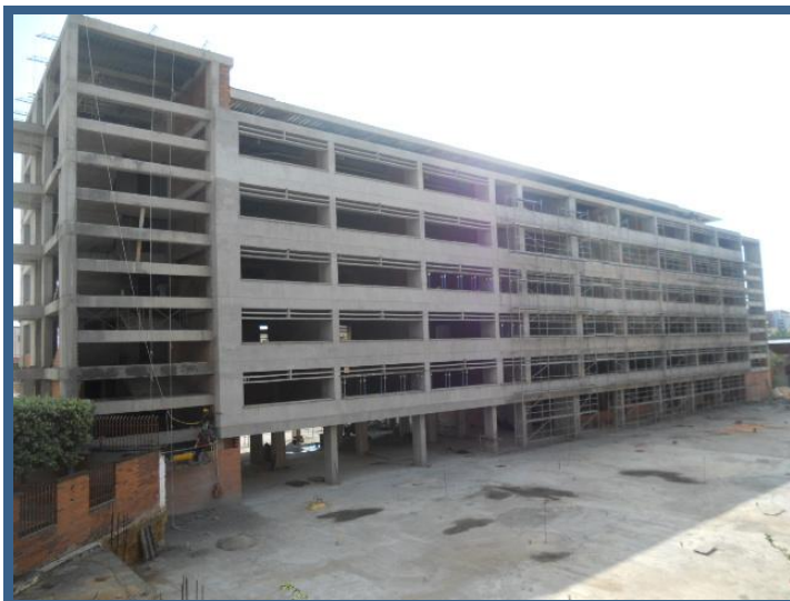
Avance de la Primera, etapa del proyecto de Ampliación y Adecuación de la actual planta física en Bucaramanga
